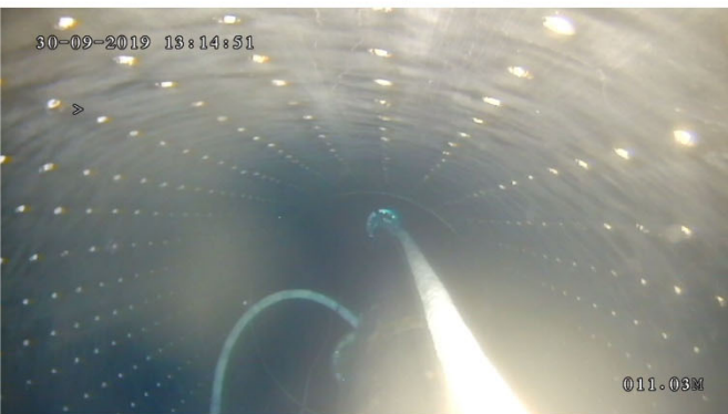
Crépines - vue générale
