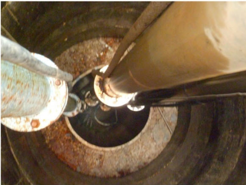
Vue sur l'avant puits lors du pompage de 2015
