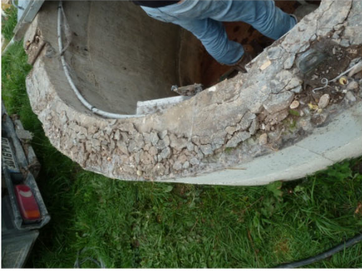
Altération sommet cuvelage
